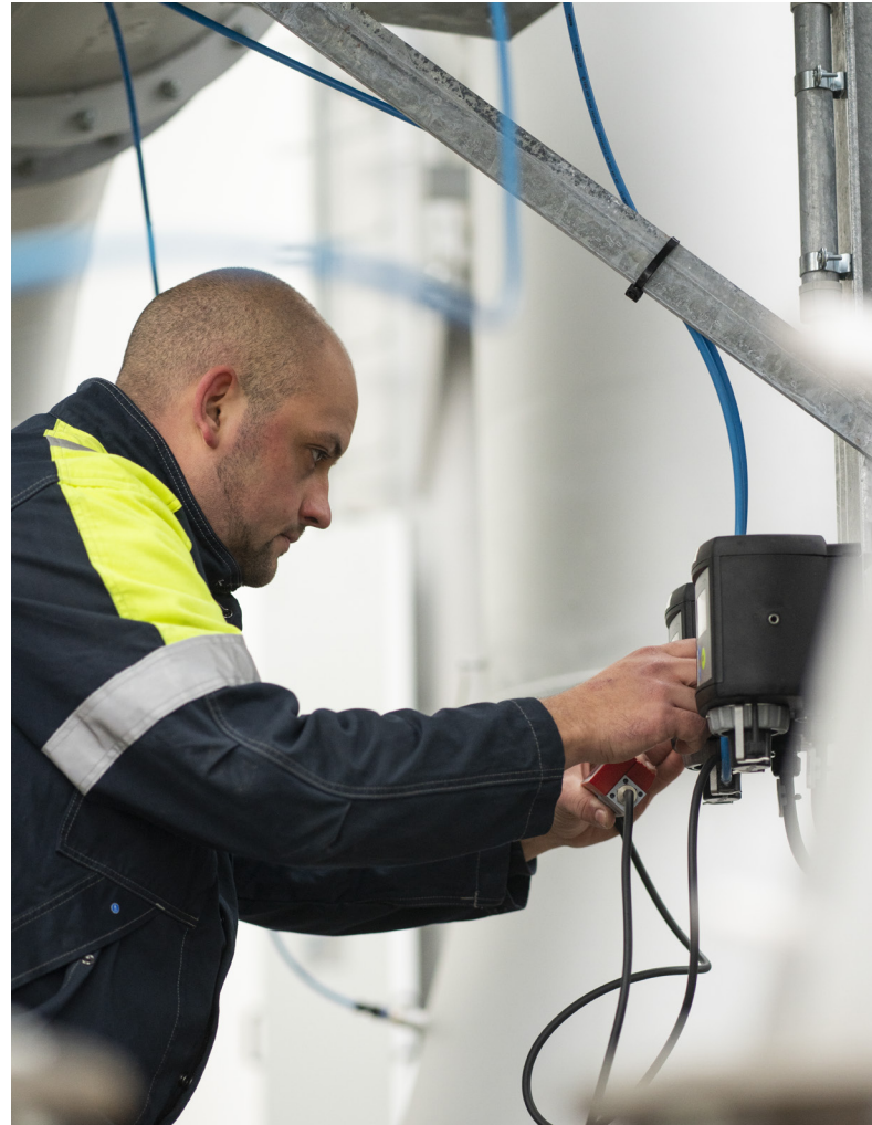
Servicetechniker Holger Lange wartet den Polytron® 7000.
