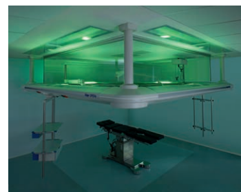
Sala operacyjna na przykład z systemem sufitowych belek zasilających OPERA®
