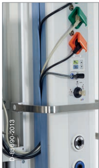
Gestión de cables para un puesto de trabajo ordenado
